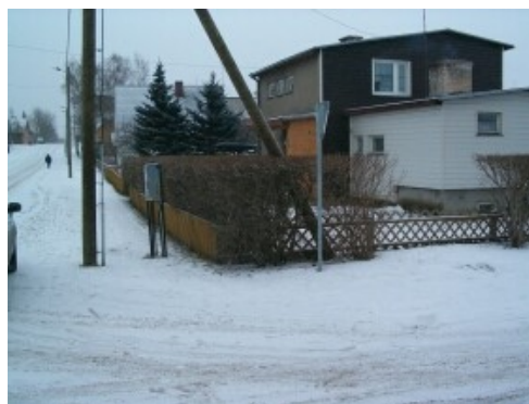
Joonis 3.6. Vahtra sademevee pumpla välisvaade. Tänavanurgal on näha pumpla elektrikilp.
